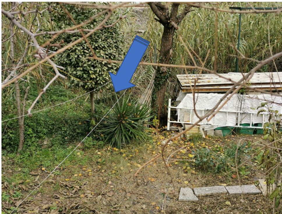
Figura 58. Vista da monte del manufatto di sottopasso dello scolo Matrice Spule sulla linea ferroviaria BO-AN
