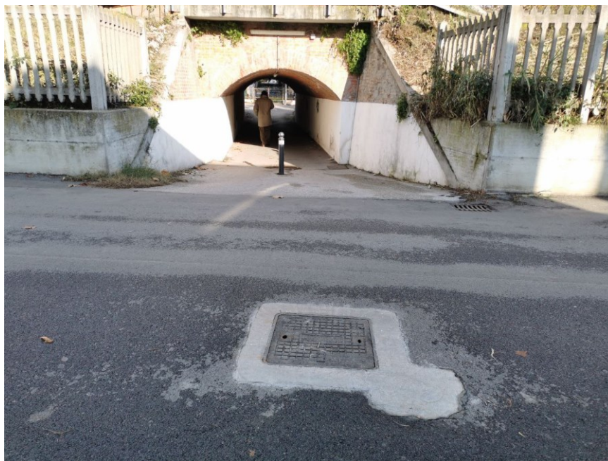
Figura 54. Vista da monte del manufatto di sottopasso dello scolo Dossetto sulla linea ferroviaria BO-AN
